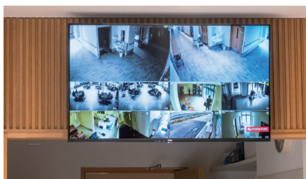
施設内各所が映し出されたモニター。
